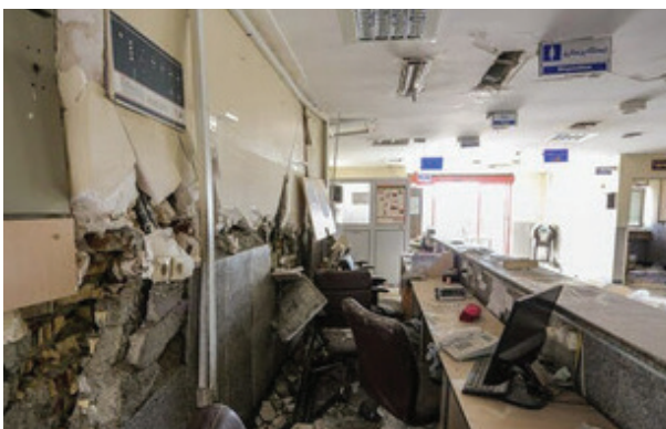
تصویر ف-۱- آسیب دیدن بیمارستان تازه تأسیس اسلام آباد در سال ۱۳۹۶ بر اثر زلزله ۷،۳ ریشتری که ۷ ماه از آغاز به کار آن می‌گذشت.
